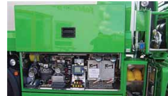
Standard Armaturenschrank am Rahmen befestigt, mit Messanlage, 2 Additivbehältern mit elektronischer Füllstandsanzeige und zusätzlichem Gebindeschrank.
