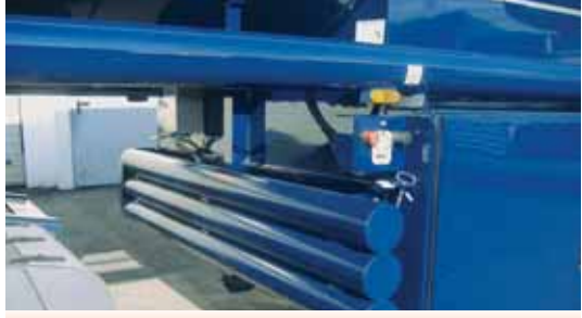
Armaturenschrank mit Querschlauchrohren.
