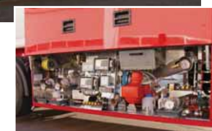
Doppelmessanlage: 1 x Heizöl / Diesel 1 x Raps / Sojaöl bis 750 l und Leerschlauch.
